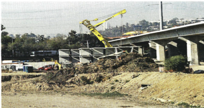
Maquinaria trabaja en las obras de conectarán la estación Santa Fe del Tren Interurbano con el Complejo Observatorio, en el que convergerán también las líneas 1 y 12 del Metro.
