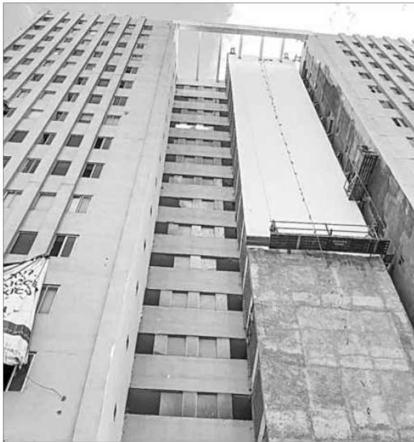
▲ Aspecto del edificio ubicado en calzada de Tlalpan 550, afectado por el sismo del 19 de septiembre de 2017, cuyos residentes han denunciado que los trabajos de reconstrucción no
