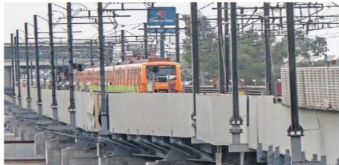
Este 3 de mayo se cumplen cuatro años del colapso en la L12; en enero de 2024 se reinició el servicio y luego de seis meses fue sometida a una revisión para detectar cualquier anomalía.
