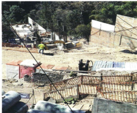
Bajo el pretexto de estabilizar taludes por lluvias, esta plancha de concreto fue colada recientemente.
