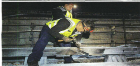
Usuarios tuvieron que ser desalojados por las vías, mientras que cuadrillas intervenían en la zona del corto circuito.
