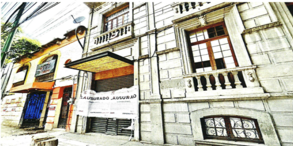
Pese a estar catalogado, el inmueble de Oaxaca 89 era sometido a trabajos de demolición.
