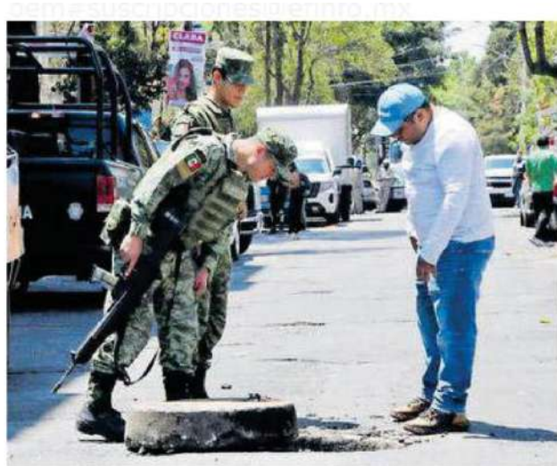
Hoy seguirán las pruebas en las tomas de Pemex para descartar fisuras
