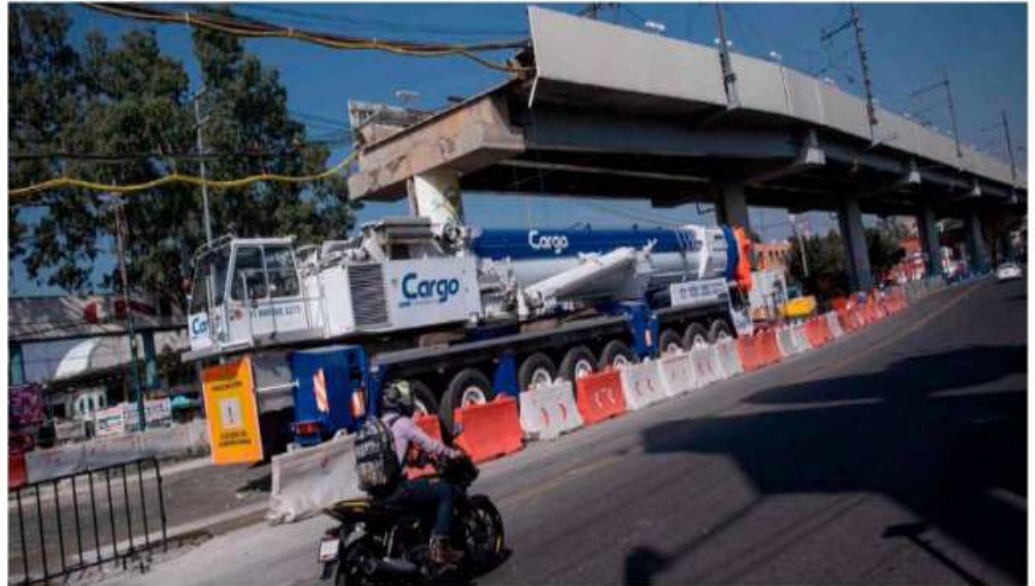
El desplome de la Línea 12 del Metro ocurrido en mayo pasado cobró la vida de 26 personas.
