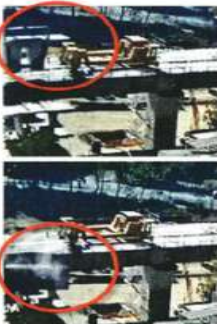
La dovela cayó cuando era maniobrada por una grúa.
