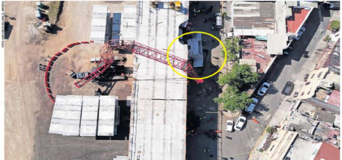
La estructura que se cayó era trasladada para ser montada en el apoyo 18. Se investiga si la falla se debió a un error en la operación o de la grúa.
