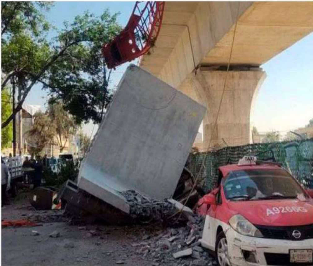
Dos vehículos fueron aplastados por el concreto.
