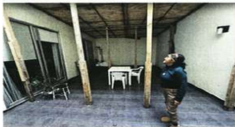
■ María Inés Cervantes, vecina de Granadas, muestra el interior de su casa, dañada por la construcción de una torre.
