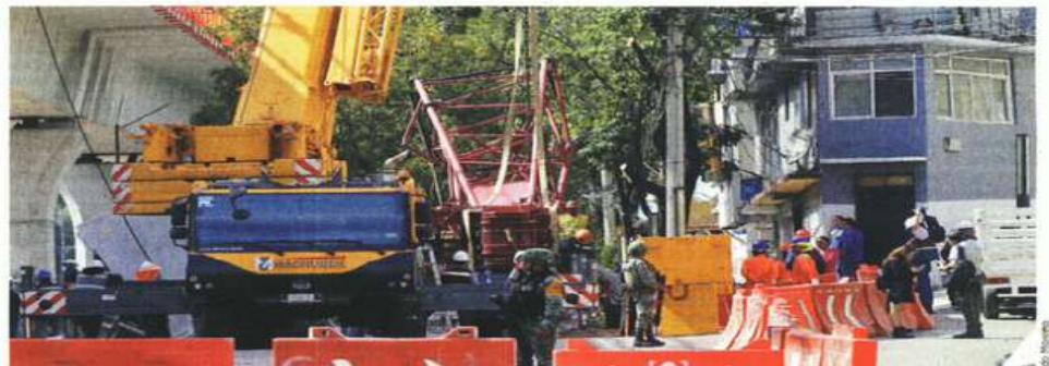
El tramo donde cayó la dovela se mantiene vigilado por elementos de seguridad.
