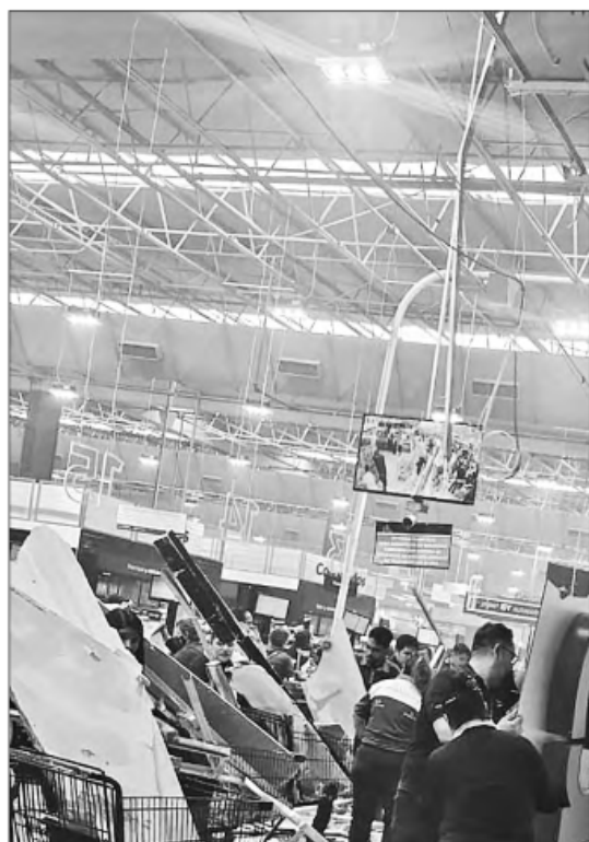
▲ La caída del falso plafón de unos 80 metros en una tienda de autoservicio de Pabellón del Valle dejó el saldo de una persona lesionada y otra atendida por crisis nerviosa. Foto La Jornada
