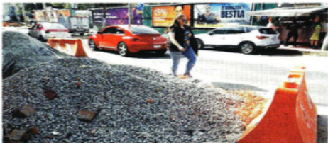
■ Material de construcción obstruye banquetas en Calle Puebla; peatones deben caminar sobre el arroyo vehicular.
