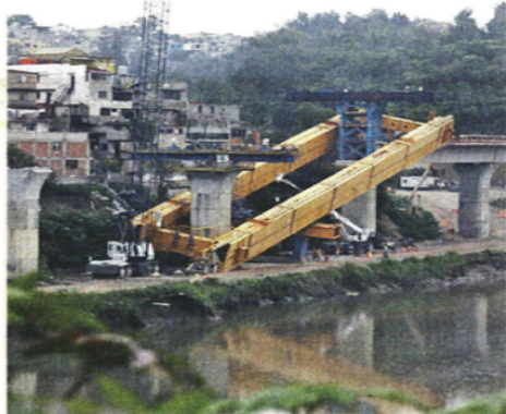
En la Presa Tacubaya, la armadora que colapsó en abril sigue sin ser retirada.
