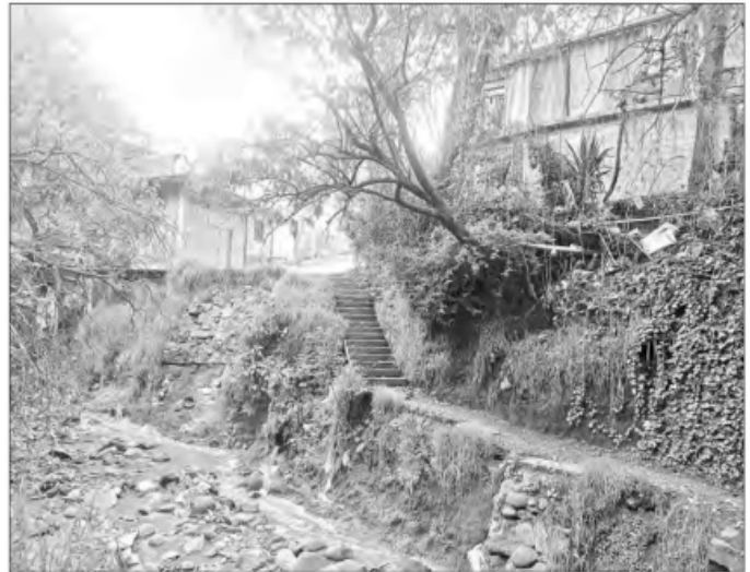
separa dos demarcaciones, al poniente, los pobladores temen que con un aguacero pueda colapsar el muro de contención. Fotos Pablo Ramos y José Antonio López
