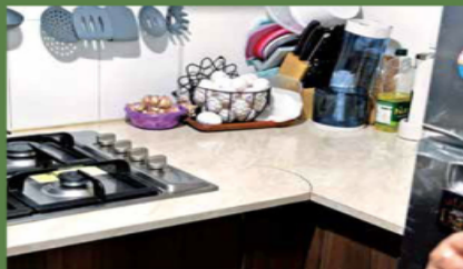
Iraís Martínez mostró cuarteaduras en su cocina y que las puertas de las habitaciones ya no cierran.
