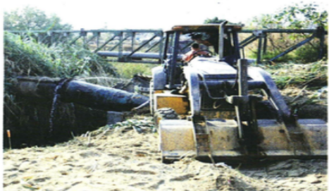
Por cuatro años, un ducto que abastece al Municipio presentó dos fugas por las que se perdieron alrededor de 315 mil litros.
