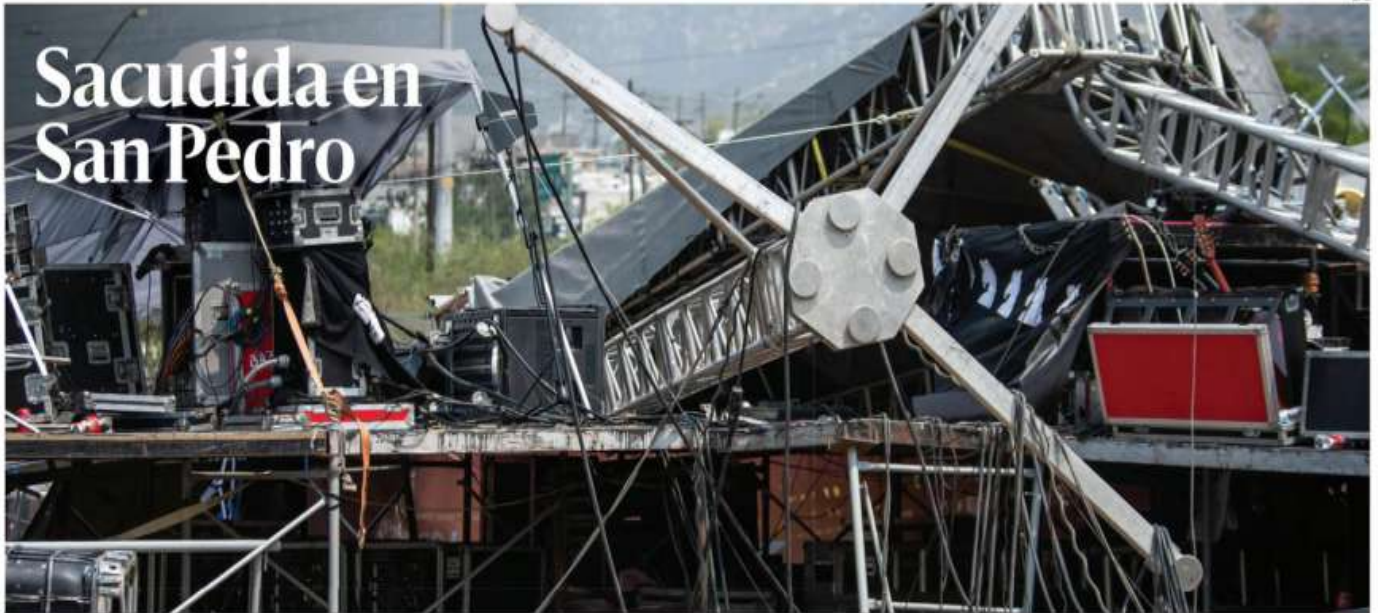
Las estructuras metálicas que soportaban el templete del mitin de Movimiento Ciudadano fueron colapsadas por las ráfagas de viento.
