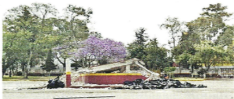
Un quiosco fue demolido por autoridades el lunes, ayer el cascajo aún yacía en el lugar.
