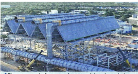
El mega apagón fue causado por gas húmedo enviado por Pemex a las plantas de CFE, vía el gasoducto Mayakán.
