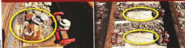
En la imagen se observa la falta de sujetadores en los rieles.
