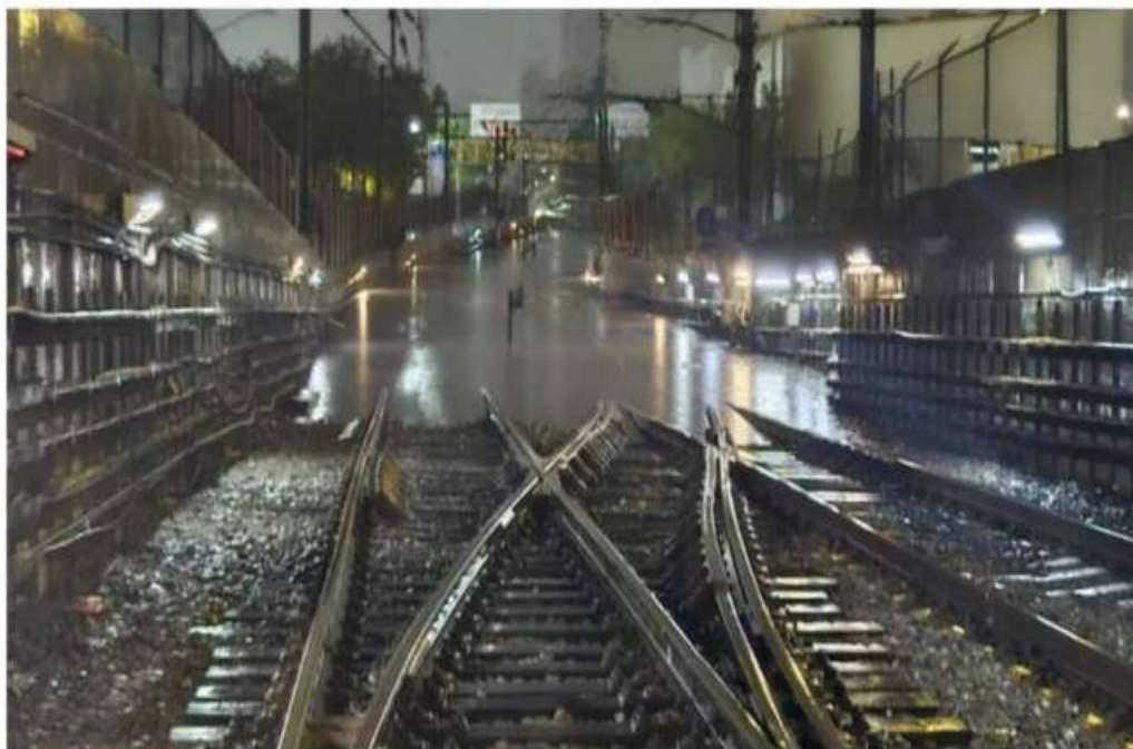
Personal de Instalaciones Hidráulicas y Mecánicas del Metro trabajó para drenar el agua que ingresó del exterior.
