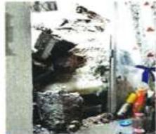
El inmueble está catalogado como zona de alto riesgo.
