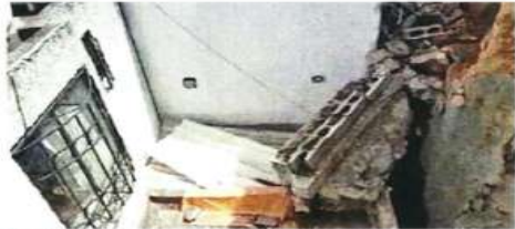
La vivienda de la familia Chavero resultó dañada por el desprendimiento de un cerro.
