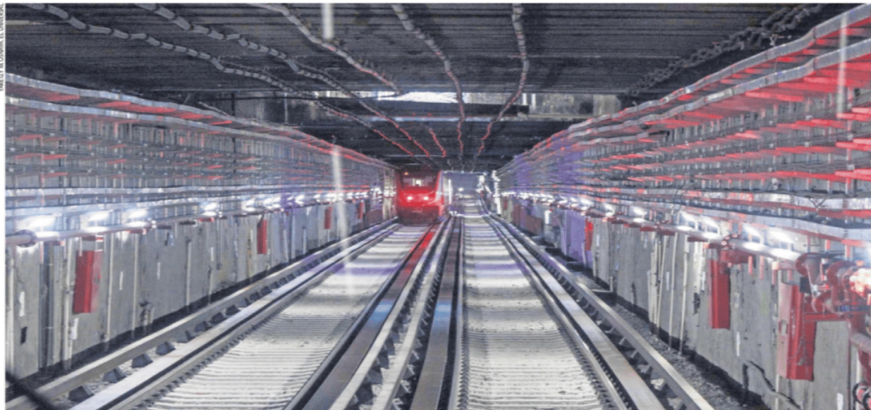
Actualmente se llevan a cabo pruebas referentes al software, que permite el pilotaje automático del CBTC de la Línea Rosa, explicó la jefa de Gobierno, Clara Brugada.
